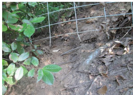
イノシシ柵破損箇所(ウリ坊は通る)補修完
