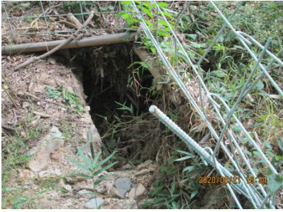
鐘鋳場陥没ヶ所
