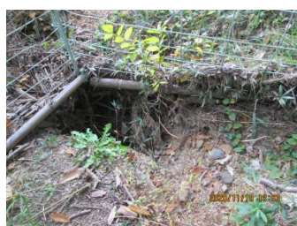
鐘鉢場陥没箇所
